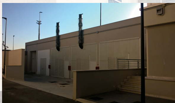
Nuova centrale elettrica a servizio dei nuovi insediamenti
