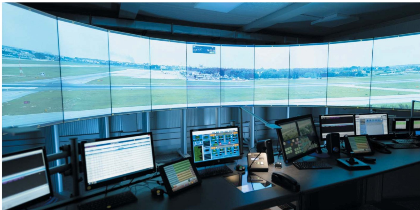
La control room delle nuove torri di controllo virtuali di Enav , con le informazioni completamente digitalizzate
